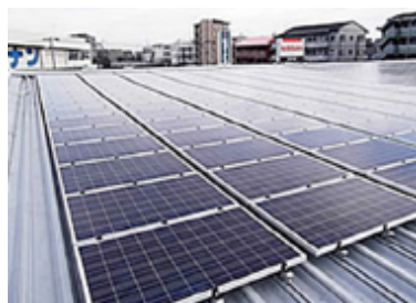
神奈川県日産自動車(株)の一部の販売店の屋根に設置した太陽光パネル。得られた電力を日産PPSとして調達し販売店に供給しています
