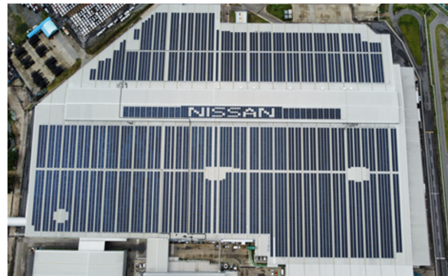
タイ工場の5.5MWの太陽光発電
