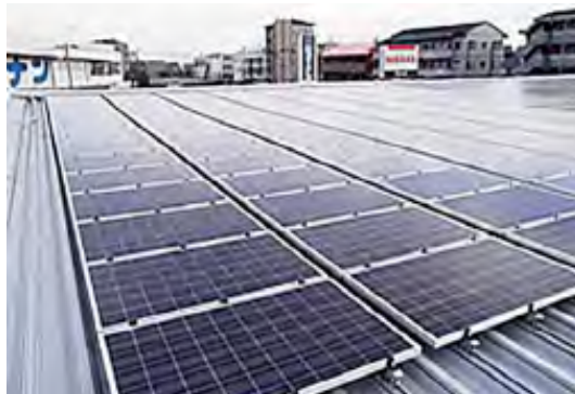
神奈川県日産自動車(株)の一部の販売店の屋根に設置した太陽光パネル。得られた電力を日産PPSとして調達し販売店に供給しています
