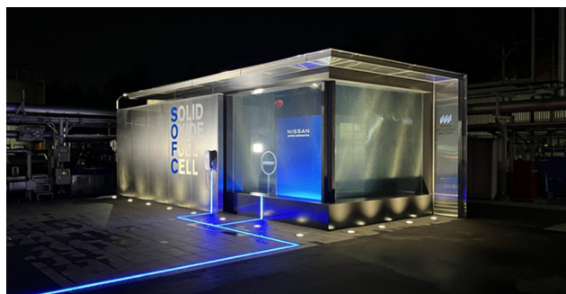
図7 栃木工場に導入したSOFCシステム外観
