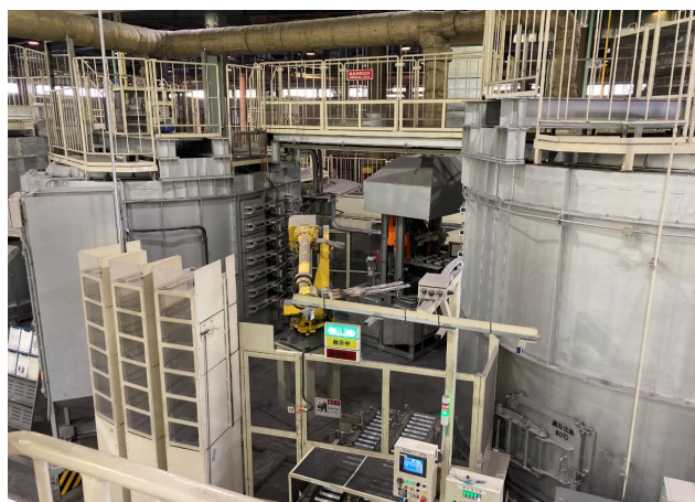
図16 熱処理炉外観
