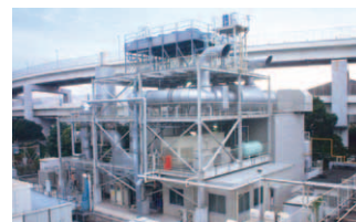
コジェネレーション設備※ Co-generation system※
