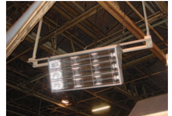
パネルヒータの設置 Panel Heat Installatio
